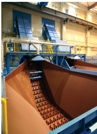
写真4 受入供給コンベヤ
